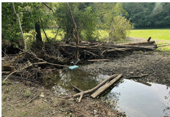
Stav po opadnutí vody
