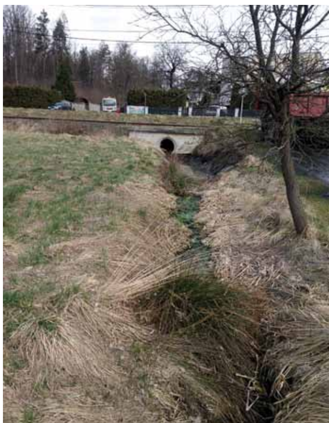
Stav před vyčištěním vyústění odpadních vod
